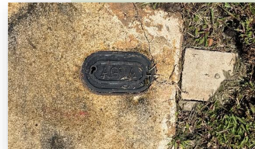
MEDIDOR DE AGUA
